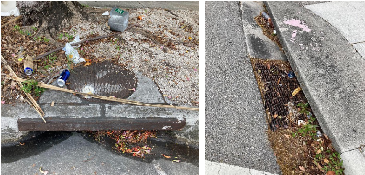
Figura 49: Ejemplo de desagües pluviales en Miami sin rejilla o filtro (izquierda) y basura fuera de lugar siendo detenida por una versión antigua de una rejilla de desagüe pluvial (derecha)
